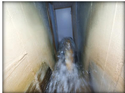
Vandet falder fra filtre ned i tanken.
