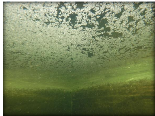
Meget kalk i overfladen, især i rummene under filtrene.
